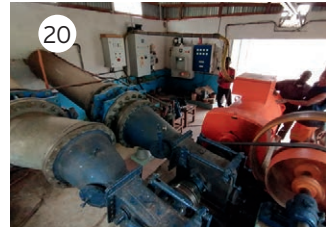
20 Im Generator-Raum summen die Turbinen.
